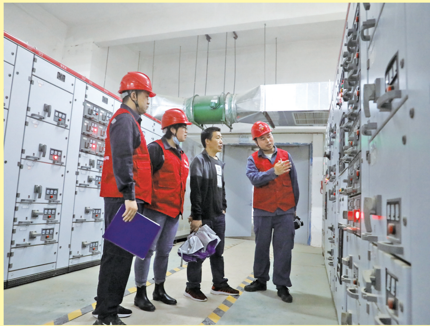
凯里市郊供电局工作人员与学校电工对线路设备进行安全检查
