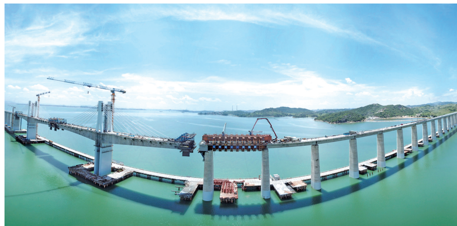
9月6日上午,由中铁十一局承建的新建厦福铁路湄洲湾跨海大桥最后一孔移动模架现浇梁开始浇筑,并将于当晚结束浇筑,完成首次海上高铁架梁任务。这个被称为“高空移动的桥梁预制工厂”的高铁移动模架,可行进在已完成的桥墩进行高铁箱梁现浇施工,最大承载重量达1200吨,可抵御14级台风,解决了“千吨级”40米箱梁海域现浇施工的难题,是我国目前最大跨度的高铁移动模架。(新华社记者 宋为伟 摄)
