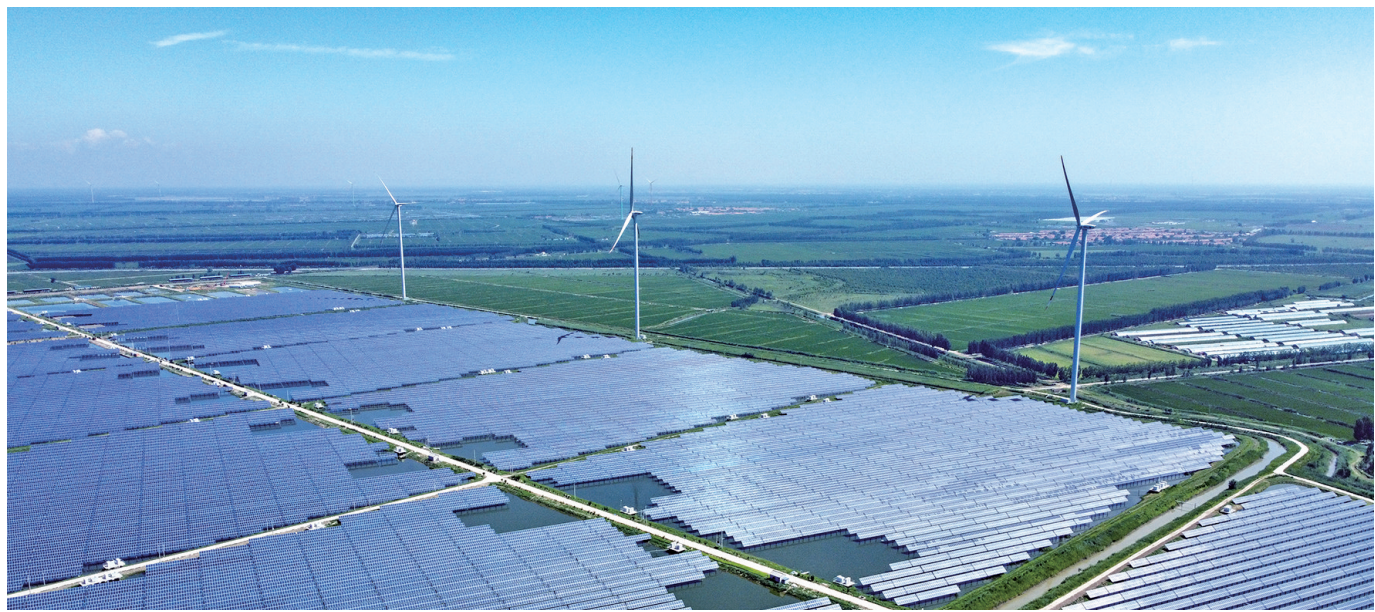
这是在天津市宁河区宁河镇大月河村拍摄的110千伏大月河光伏电站(2022年7月18日摄)。(新华社记者孙凡越摄)
