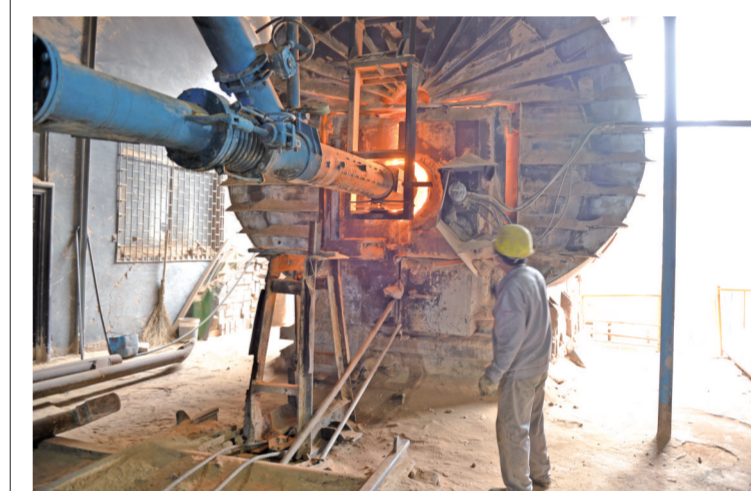
近日,笔者走进凯里市鑫泰熔料有限公司生产车间,到处是工人们的忙碌身影。鑫泰熔料公司位于炉山工业园区,该企业主要以水处理剂系列产品的研发、生产、经营和铝酸盐水泥建筑等新材料生产为主营业务,远销广东、上海、浙江一带,供不应求。图为日前工作人员在熔烧车间察看设备的情景。(通讯员 李茂奎 摄)
