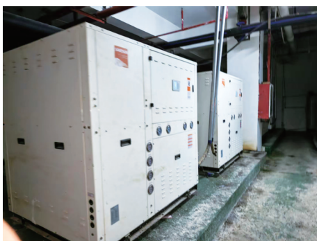
台江县委党校地源热泵中央空调系统
