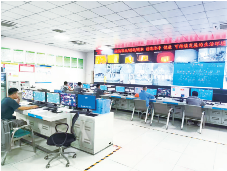
生活垃圾发电厂内景
