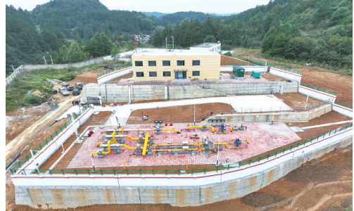
福泉至炉山项目炉山输气站
