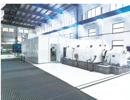
生活垃圾发电厂内景
