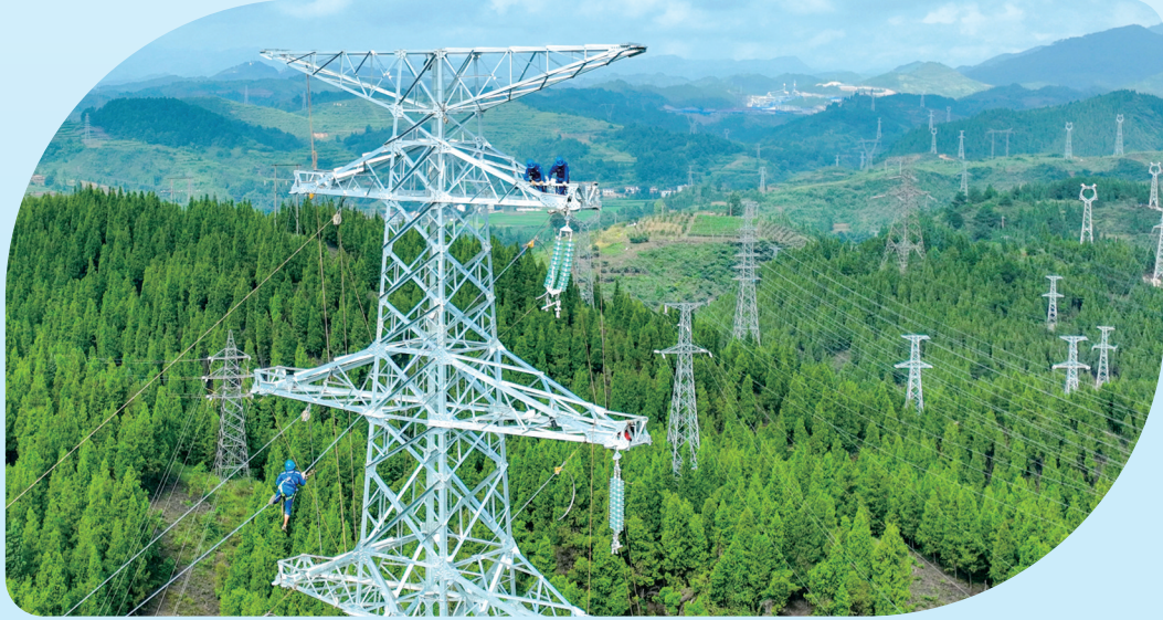
2024年8月30日拍摄的岑巩县工业园区35千伏电网铁塔(通讯员 杨启志 摄)
